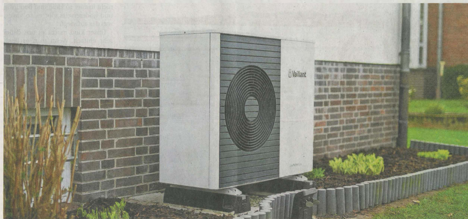
Auch für den erstmaligen Einbau einer Wärmepumpe gab es bislang in Düsseldorf über ein stadt eigenes Programm Unterstützung.
